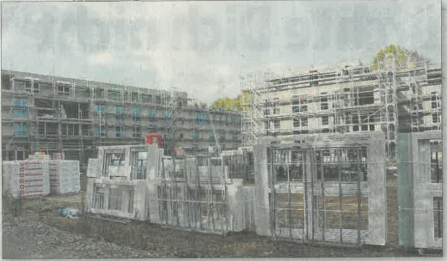
Es geht voran auf der Baustelle. Die Fenster warten darauf eingesetzt zu werden.
